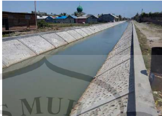
Gambar 2. 7 Saluran Drainase Buatan ( Artificial Drainage )
