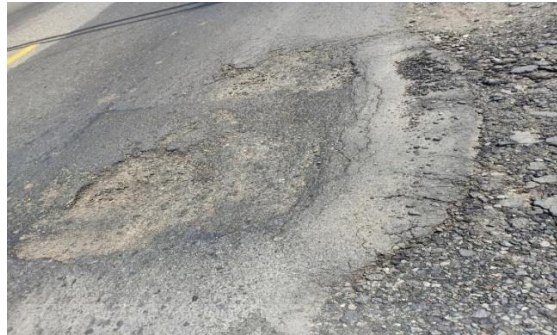
Gambar 1.1 Jenis Kerusakan Sungkur
