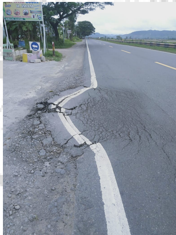
Gambar 1.1 Jenis Kerusakan Sungkur ( Sumber : Dokumentasi 2022)
