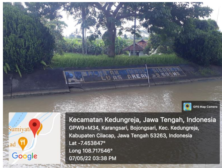
Gambar 1.2 Rusak Sedang Saluran Primer Sidareja (Sumber : Dokumentasi Pribadi 2022)
