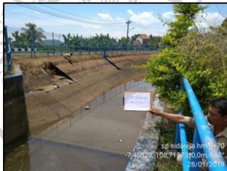
Gambar 1.3 Rusak Berat Saluran Primer Sidareja (Sumber : UPTD Pengairan Sidareja, 2019)
