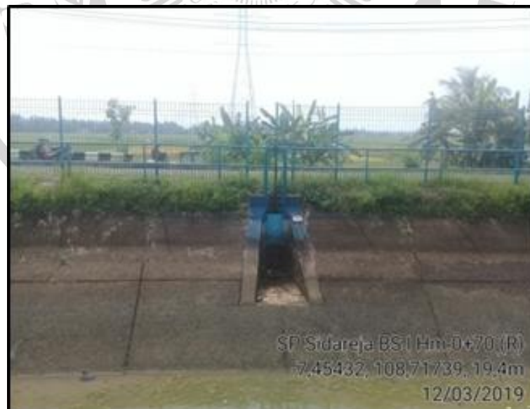
Gambar 1.1 Rusak Ringan Saluran Primer Sidareja
