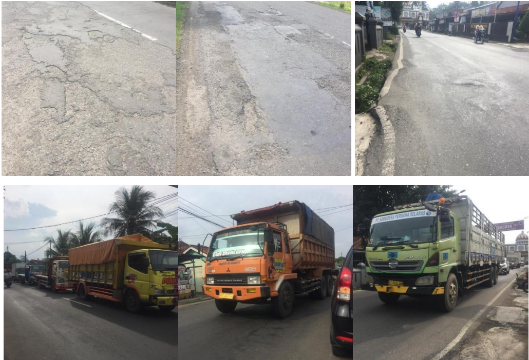
Gambar 1.3 Kondisi Ruas Jalan Kaliori-Patikraja Sumber : (Dokumentasi Pribadi 2022)
