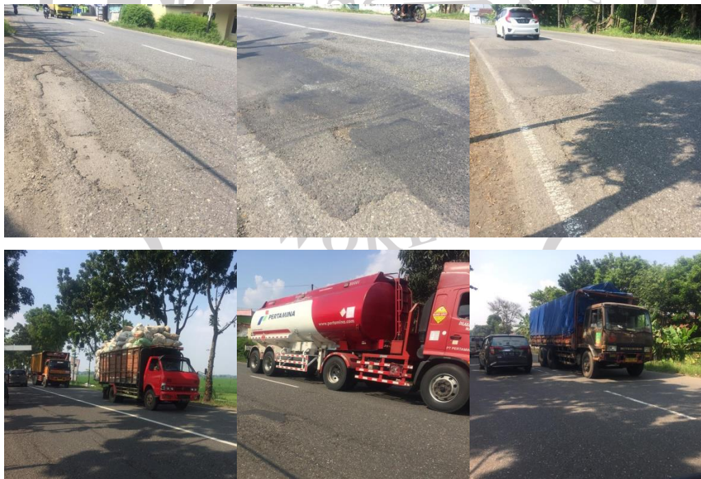
Gambar 1.2 Kondisi Ruas Jalan Sokaraja-Kalimarah Sumber : (Dokumentasi Pribadi 2022)
