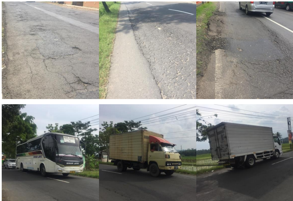
Gambar 1.1 Kondisi Ruas Jalan Purwokerto-Pegalongan Sumber : (Dokumentasi Pribadi 2022)
