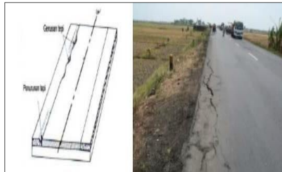
Gambar 2.10. Retak Samping Jalan Sumber : Bina marga no.03/MN/B/1983
