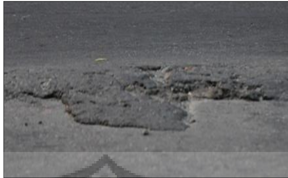
Gambar 2.12 Kegemukan ( Bleeding ) Sumber : Bina marga no.03/MN/B/1983
