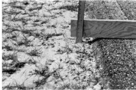
Gambar 2.13 Penurunan bahu jalan
