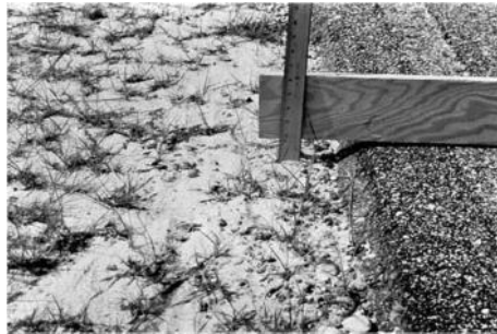
Gambar 2.13 Penurunan bahu jalan
