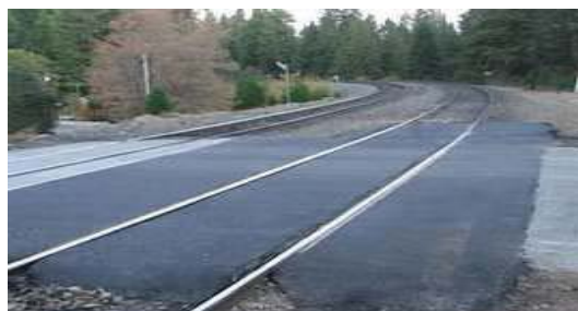
Gambar 2.27 kerusakan pada persilangan jalan rel
