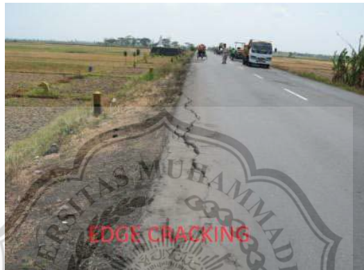
Gambar 2.19 Bahu jalan turun terhadap perkerasan aspal.
