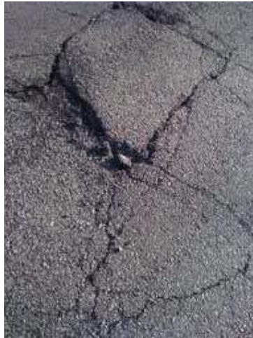
Gambar 2.6 naiknya tanah dasar akibat pengembangan yang menghasilkan retak parah dipermukaan perkerasan.
