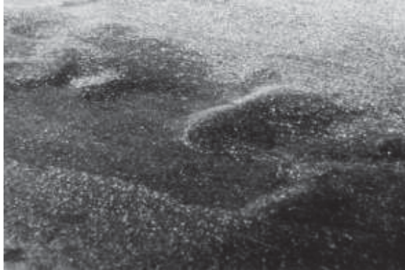
Gambar 2.5 sungkur akibat beban lalu lintas berat
