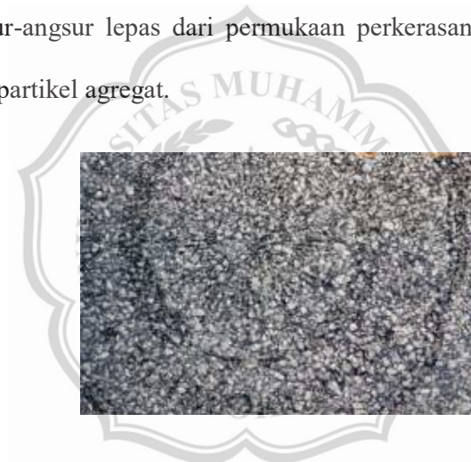
Gambar 2.20 Rusaknya permukaan perkerasan akibat butiran lepas ( raveling )
